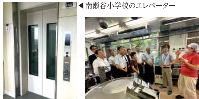
南瀬谷小学校のエレベーター
